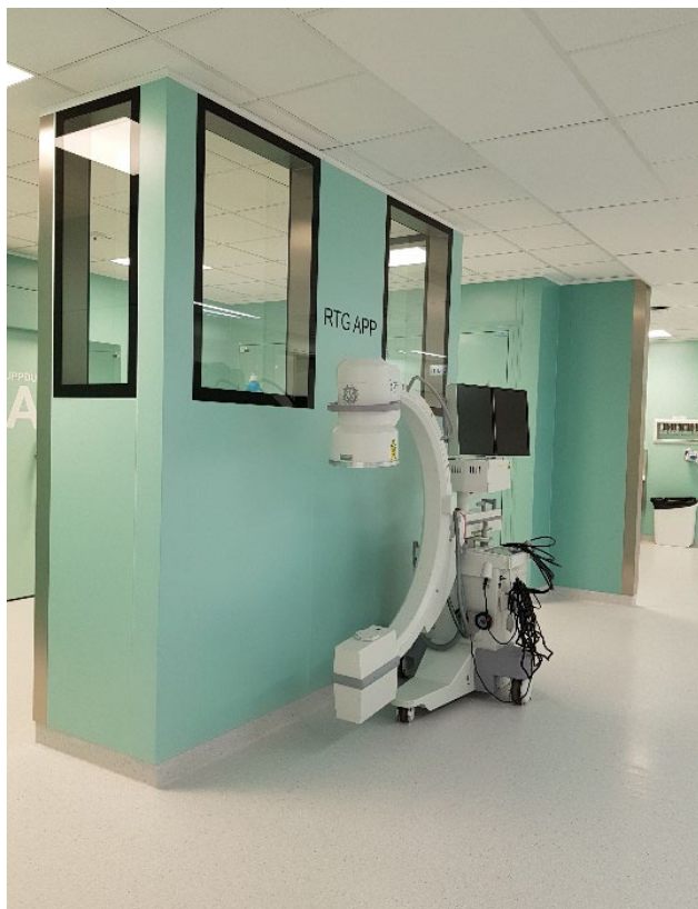
Planerad yta för C-båge i korridor
