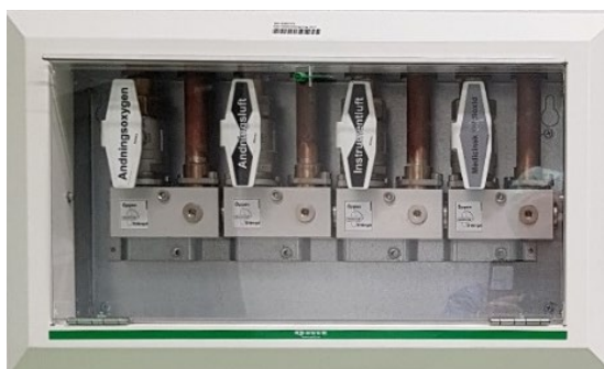
Nödavstängning gaser, inbyggd i vägg
